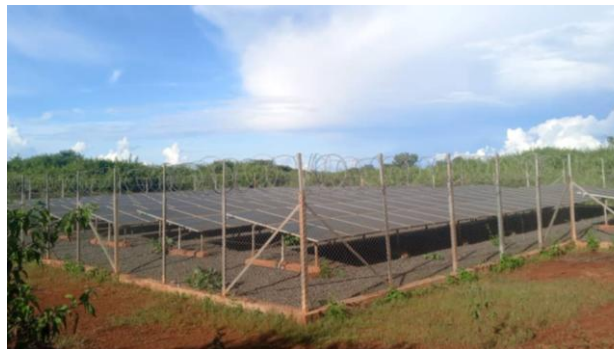
Photo 10: Plaque solaire à Daber Mbang
