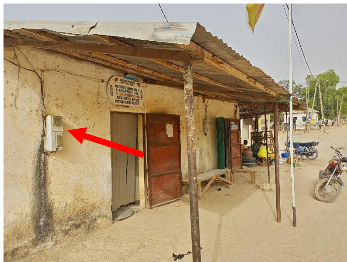
Photo 17 : Présence d'un compteur électrique à Dourbeye dans le Mayo-Oulo
